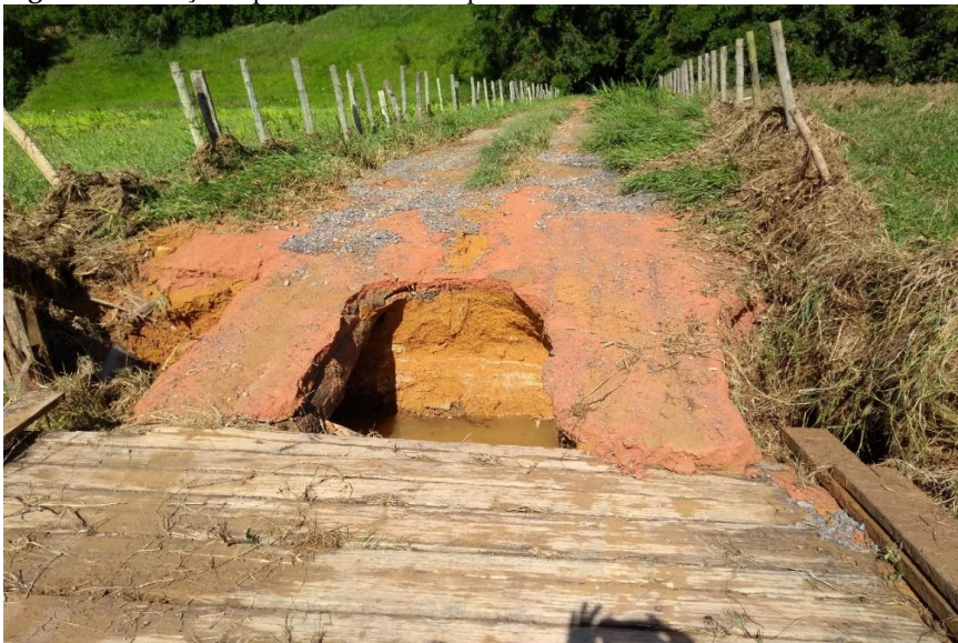
Figura 2 - Cabeça de ponte esburacada por enchente.
