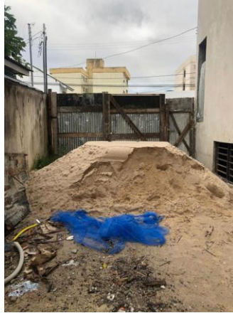
Figura 2 – Armazenamento inadequado da areia no canteiro de obras.
