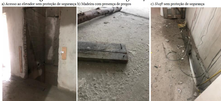
Figura 5 – Problemas relativo à segurança no canteiro de obras
