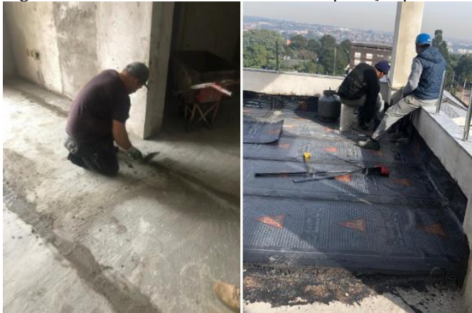
Figura 4 – Ausência dos EPIs e ausência de proteção periférica
