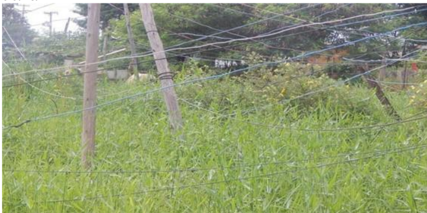
Figura 8 – Risco eminente com os chamados “gatos” para a aquisição da energia elétrica
